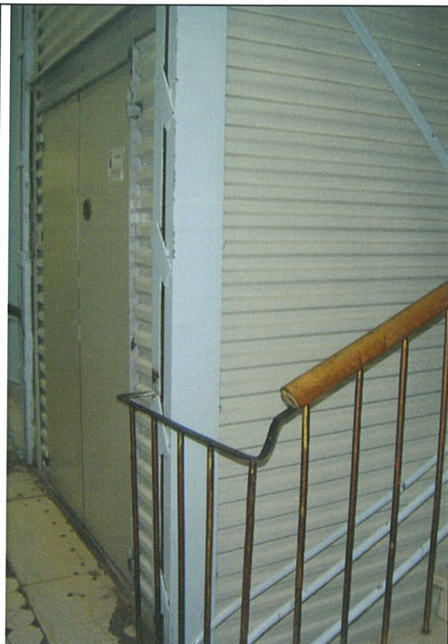
Фото 13. Поручни лестницы 3 этажа.
